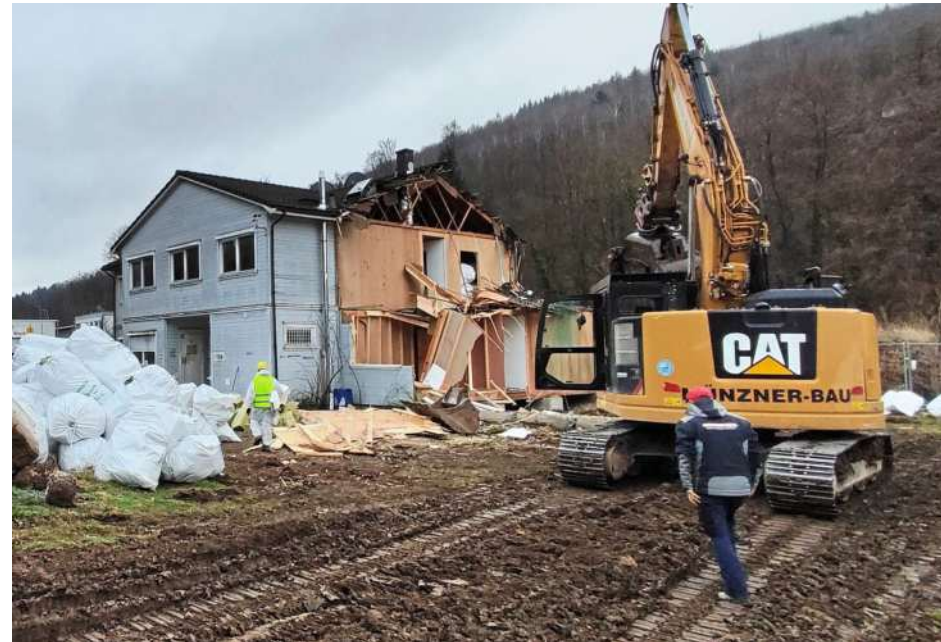
Der Abrissbagger ist bei den bisherigen Obdachlosenunterkünften in der Pforzheimer Straße in Ettlingen zugange. Die Obdachlosen sind bereits umgezogen. Foto: Rainer Obert
